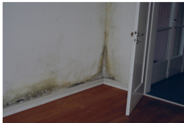
Abbildung 2: Innenansicht einer Aussenwand auf der Geschosstrenndecke zwischen Untergeschoss und Erdgeschoss (Quelle: Archiv ingBP)
